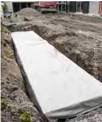
Rigolen zur langsamen Versickerung des Regenwassers
